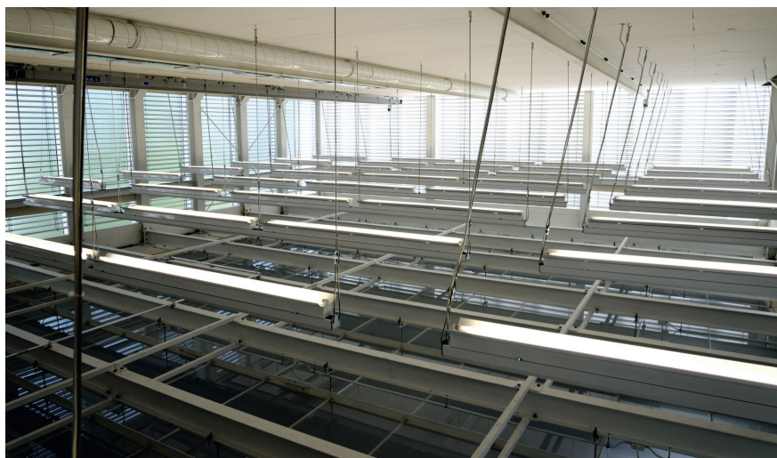
Das «Davoser Kaldach» des Kirchner-Museums leitet das Tageslicht in die Ausstellungsräume. Die Fluoreszenzröhren unterstützen das Tageslicht bei Bedarf. Mit den Lamellenstoren lässt sich das Tageslicht «dimmen».
