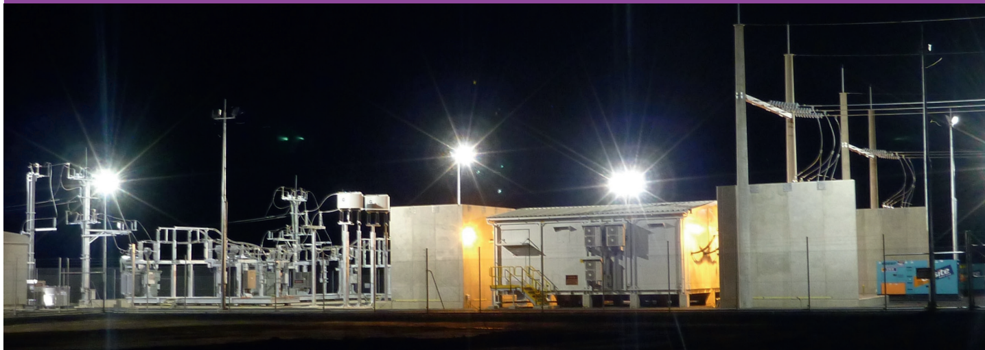
Erster 50-Hz-Phasenwandler weltweit in Memooloo (Queensland, AU), an 3 AC 132 kV.
