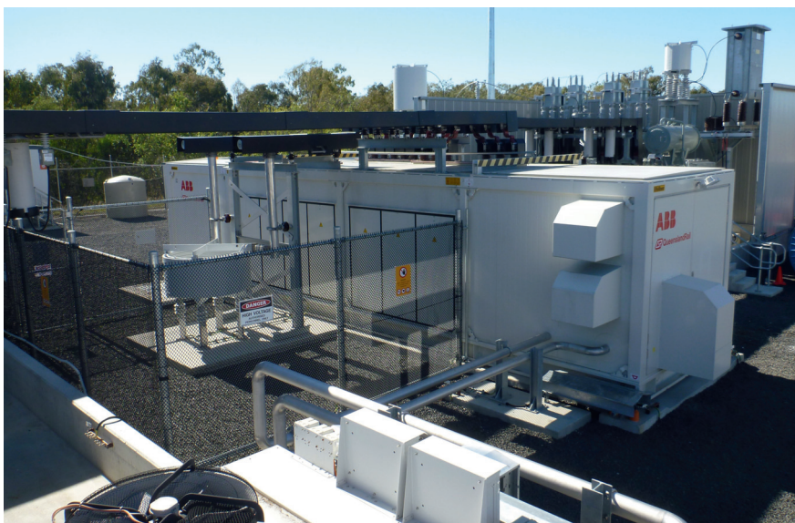
Bild 4 20-MVA-Phasenwandler in Wulkuraka (Queensland, AU), an 3 AC 110 kV 50 Hz.
