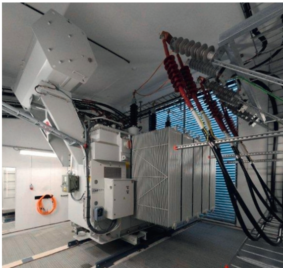
Bild 3 15-MVA-Frequenz- und Phasenwandler in Stavanger (NO), an 3 AC 45 kV 50 Hz.
