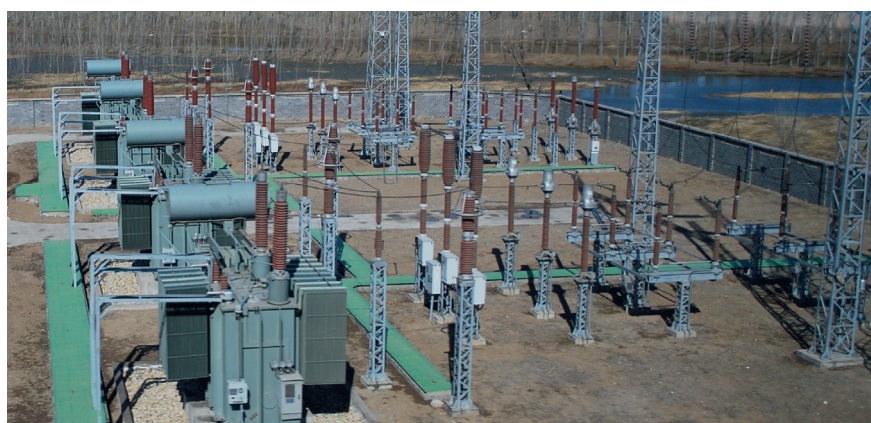
Bild 2 Freiluftanlage eines Bahnumspannwerkes an 3 AC 220 kV 50 Hz mit je zwei Einphasenumspannern 31,5 MVA in V-Schaltung, davon zwei in Stand-by-Modus, an 3 AC 220 kV 50 Hz.
