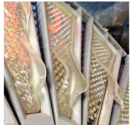
Eine Leuchte für ein Stahlwerk, bei der der Hersteller versichert hat, der Kunststoff sei bis 140°C hitzebeständig. Nun setzt man Leuchten mit Glasfront ein.
