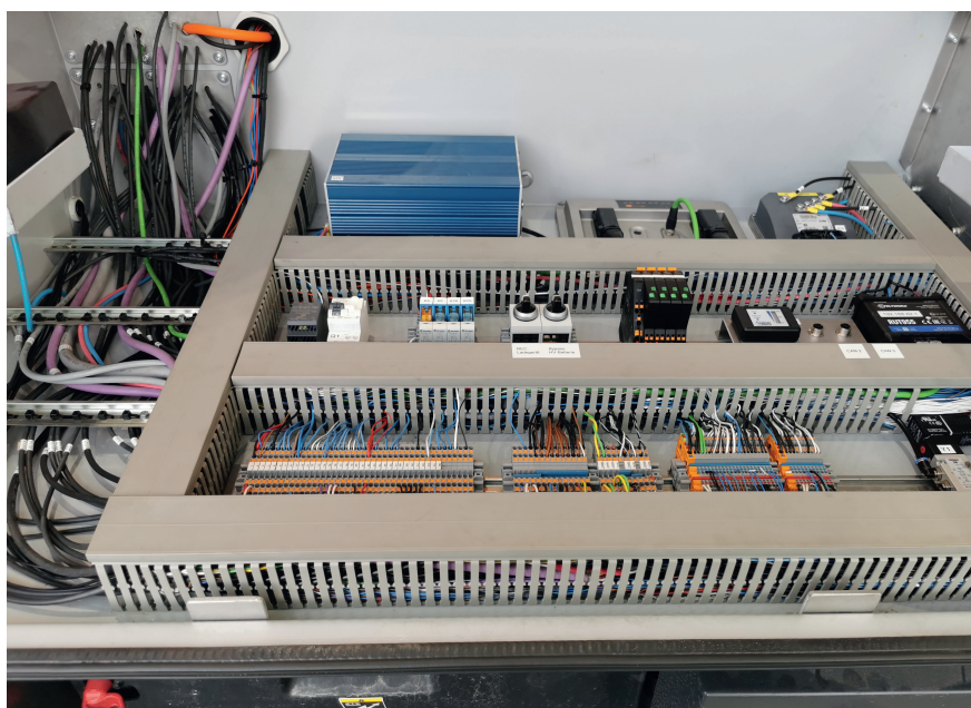
Eine Sicherheitssteuerung mit zwei unabhängigen Prozessoren und diversen Sensoren für Lage, Gewicht und Druck garantieren einen sicheren Betrieb.
