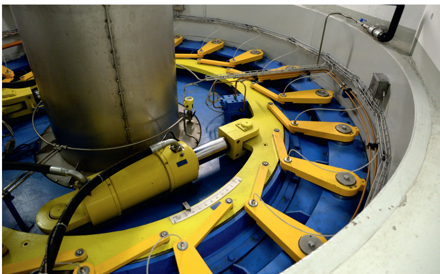
Der hydraulische Antrieb und die Stellhebel des Leitapparats für die vertikale Kaplanturbine.
