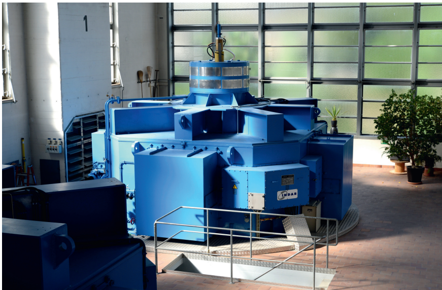
Einer der zwei zwanzigjährigen Generatoren der baskischen Firma Indar mit einer Nennleistung von 2,5 MVA in der Maschinenhalle.
