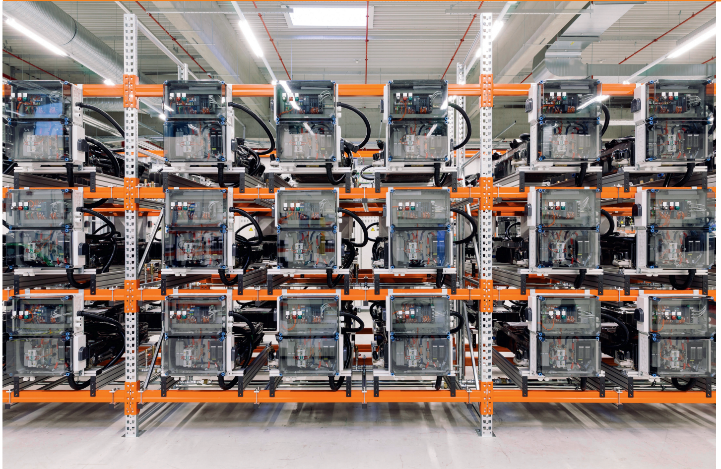
Lünen, Deutschland: der grösste 2 nd -Use-Batterie-speicher im Jahr 2016.
