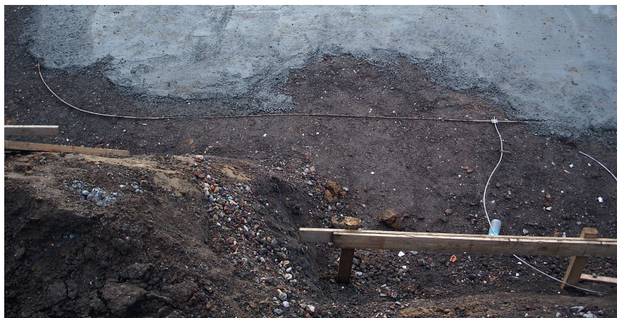
Protection intérieure contre la foudre : électrode de terre de fondation dans l'excavation d'une maison individuelle.
