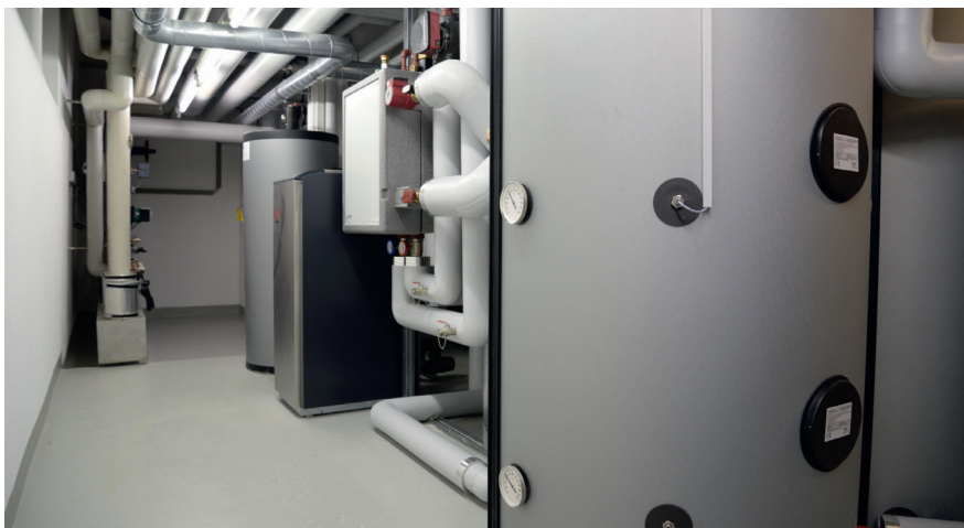
Das neue Energiekonzept sorgt nun dafür, dass es im Heizungsraum genügend Platz für Instandhaltungsarbeiten hat.
