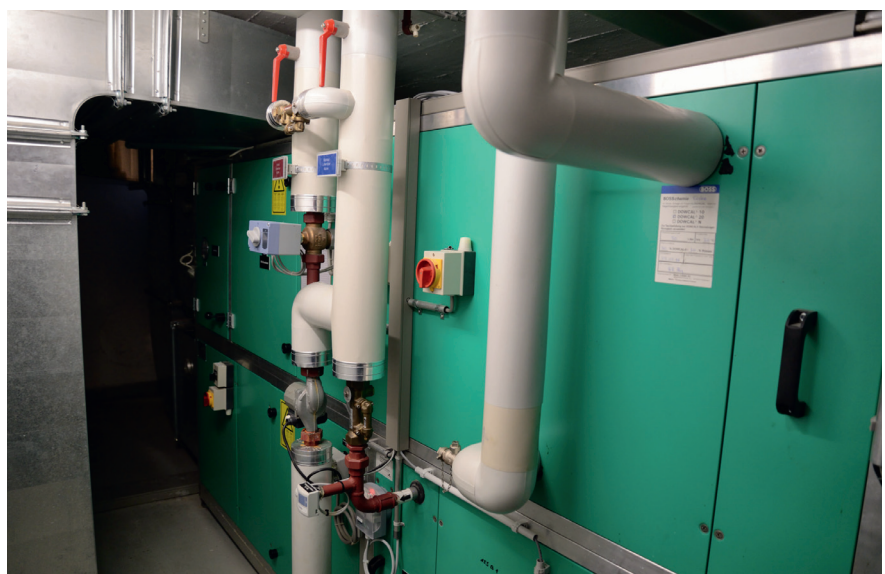
Die in der Abluft der Küche vorhandene Wärme wird auch genutzt.
