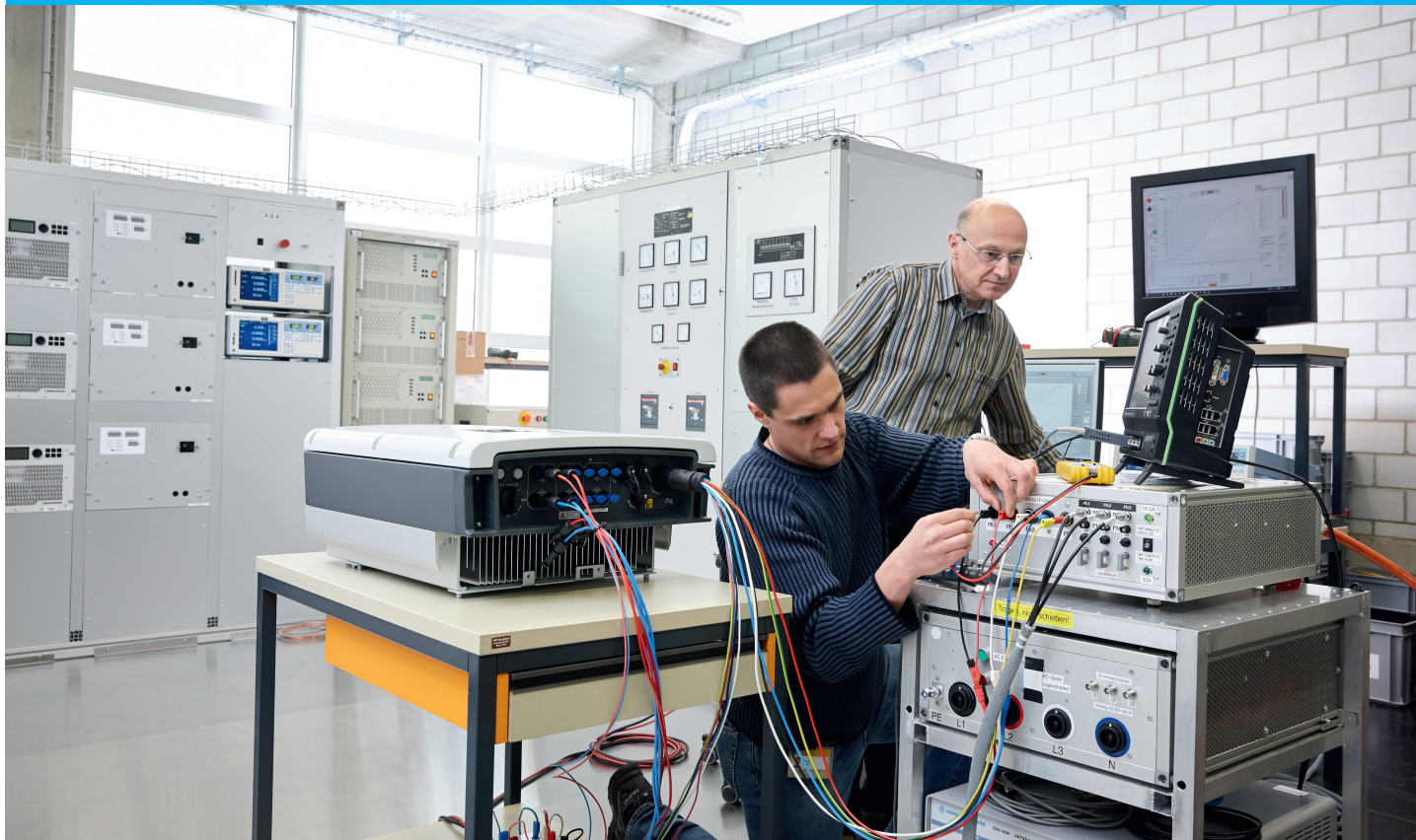
BFH-Prüflabor für PV-Wechselrichter und PV-Speichersysteme.
