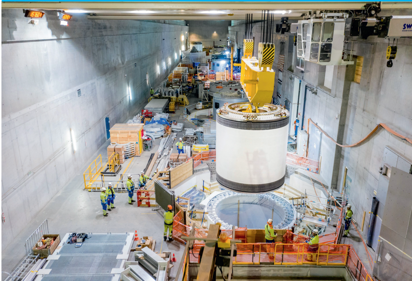
Maschinen im Kraftwerk Nant de Drance.
