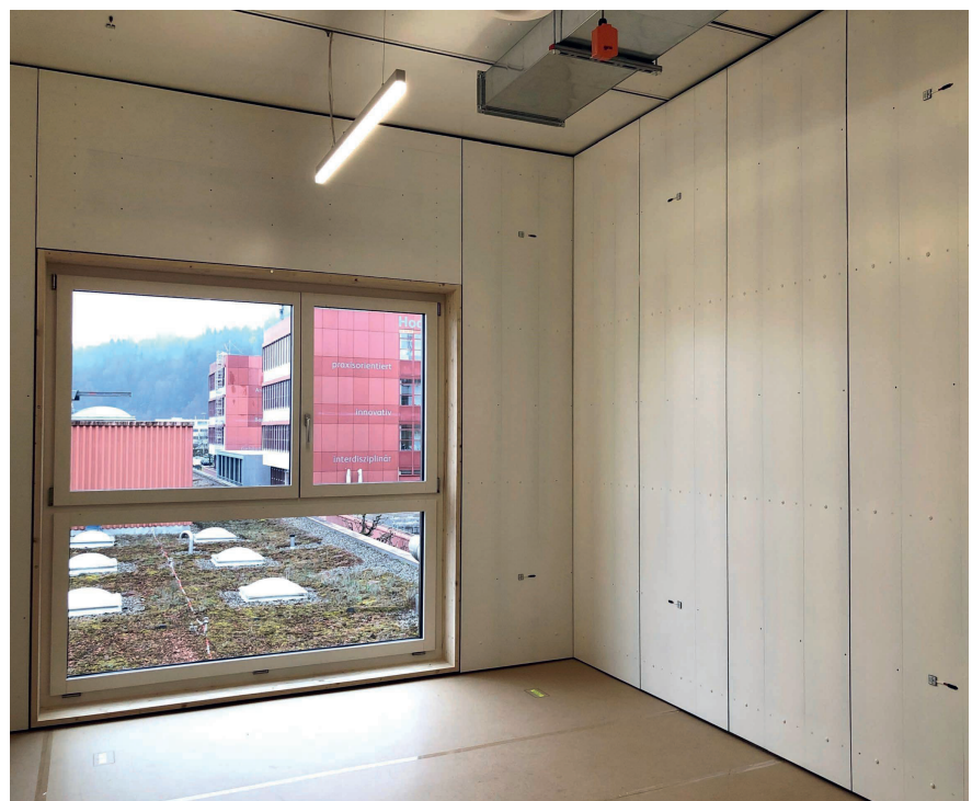
Bild 2 Frontansicht eines Wandelementes mit integrierten Kapillarrohrmatten in einem der zwei Forschungsräume.
