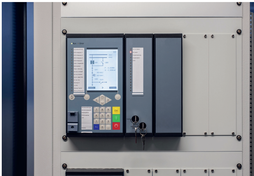
Bild 2 Das redundante, nicht vernetzte Schutzgerät wird bei Bedarf vor Ort bedient.
